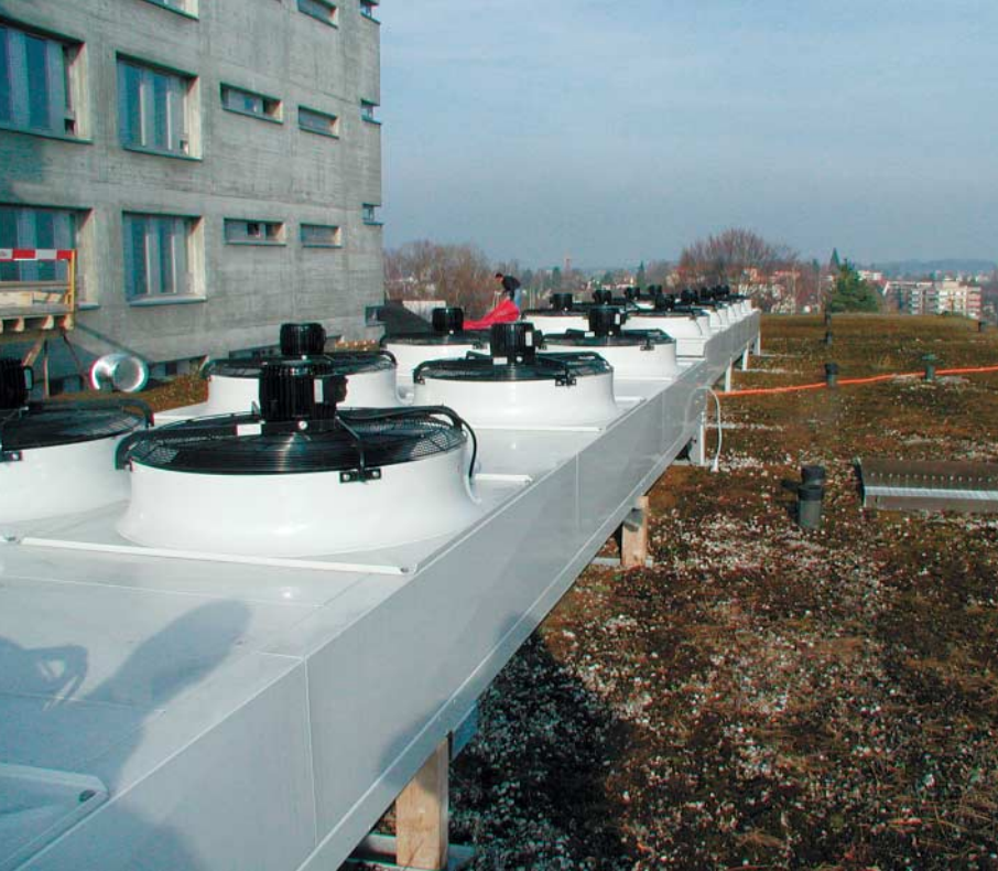
Bild 9: Rückkühlwerke der Kälte-Erzeugung auf dem Dach des Behandlungstraktes. (Foto: BUS-House)
